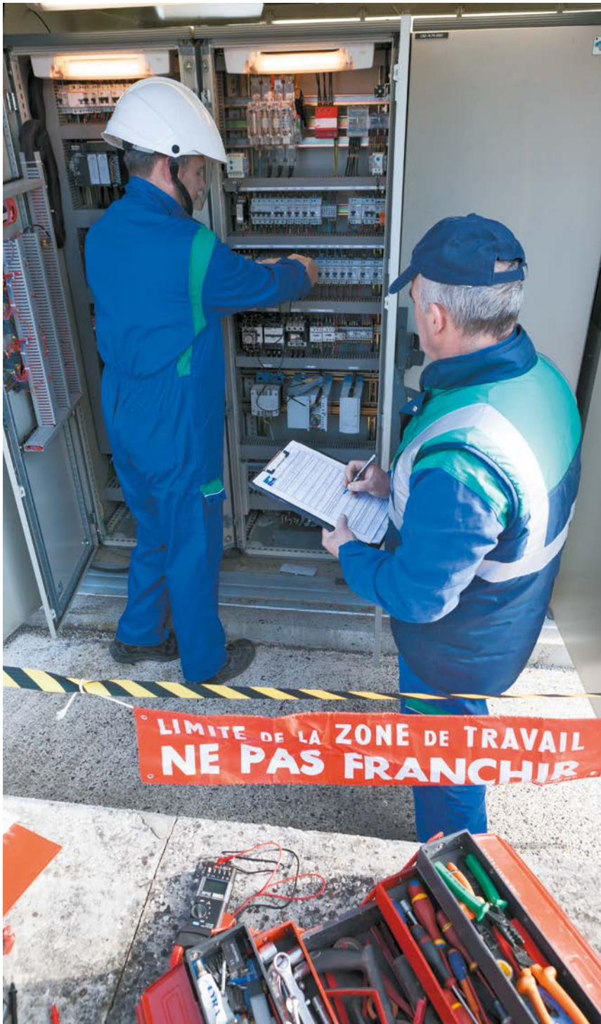
Contrôle électrique sur une écluse automatisée.
